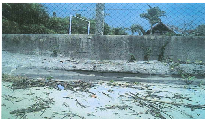
Figuras 37: A construção de muros sobre a linha de costa pode alterar a dinâmica do local, e conseqüentemente causar erosão, como pode ser visto no perfil da Casa.
