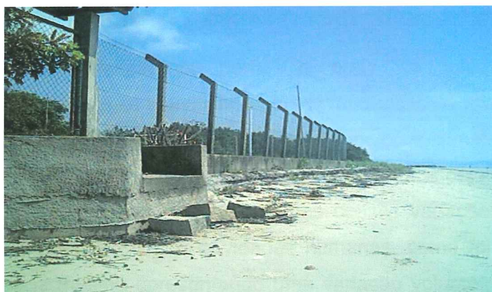
Figuras 38: A construção de muros sobre a linha de costa pode alterar a dinâmica do local, e conseqüentemente causar erosão, como pode ser visto no perfil da Casa.
