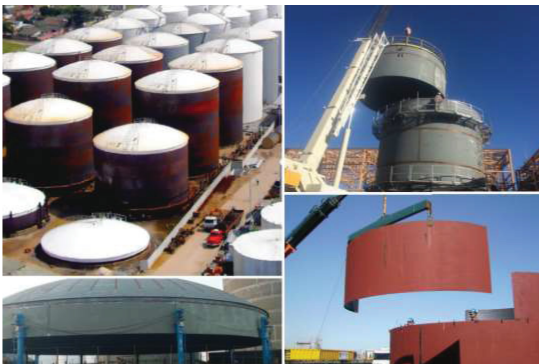
FIGURA 1 – Montagem de tanques (pelo método invertido – macacos - à esq. e pelo método tradicional – guindaste - à dir.)
