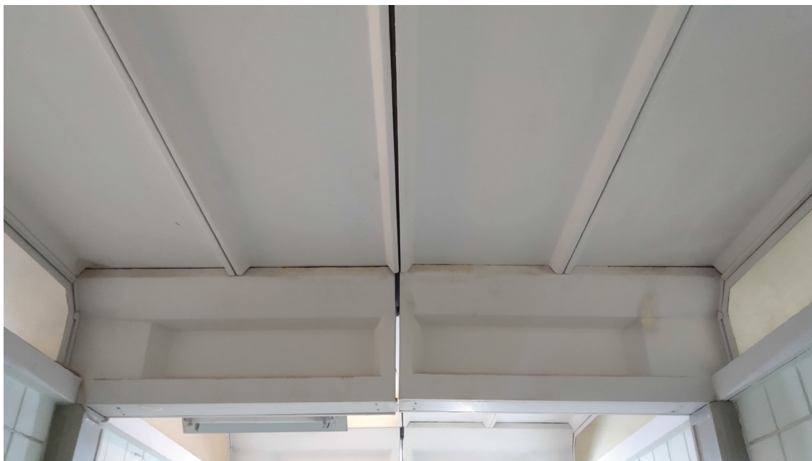
FIGURA 11 – Visão do teto da edificação mostrando a ausência de forro.
