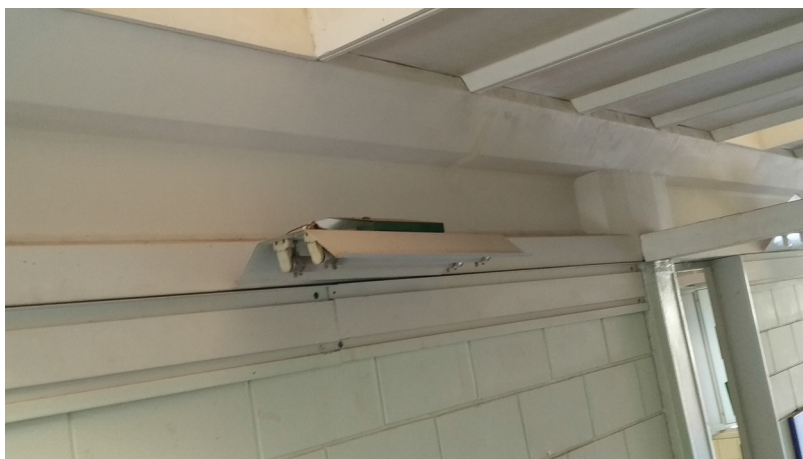
FIGURA 6 – Evidência da luminária fixada rente à parede.
