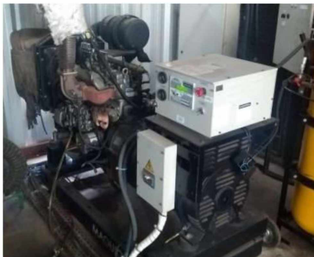
Figura 23: Motogerador presente no NPDEAS. Fonte: Mاتيolo (2020)
