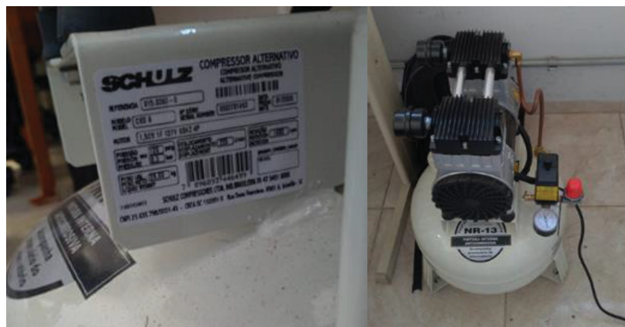
Figura 24 - Equipamento compressor de ar
