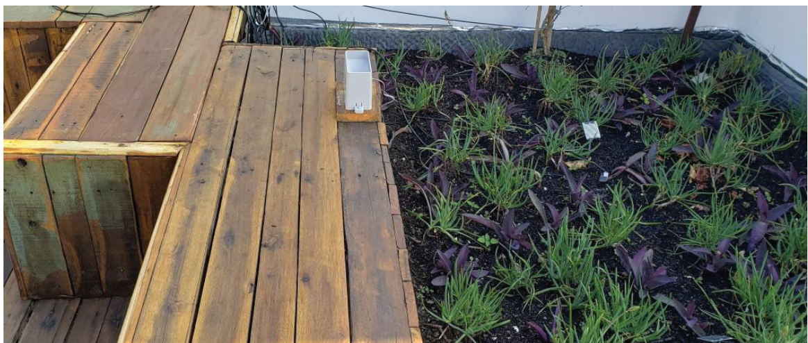
FIGURA 52 - PLUVIÔMETRO E SENSORES INSTALADOS NO LADO EXTENSIVO
