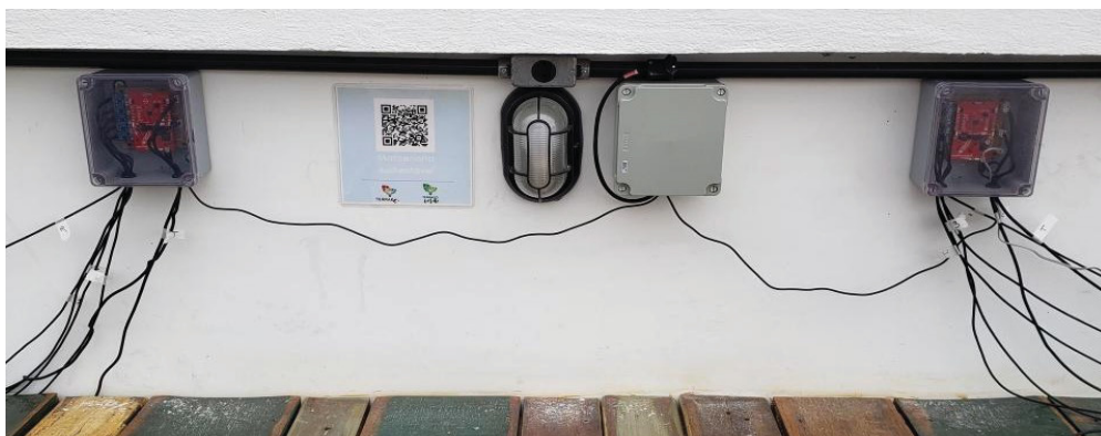
FIGURA 50 - CAIXAS DE PASSAGENS COM MICROCONTROLADORES E FONTES DE ENERGIA
