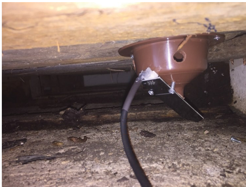
FIGURA 55 - SENSOR CAPACITIVO INSTALADO NO RALO DO CANTEIRO EXTENSIVO
