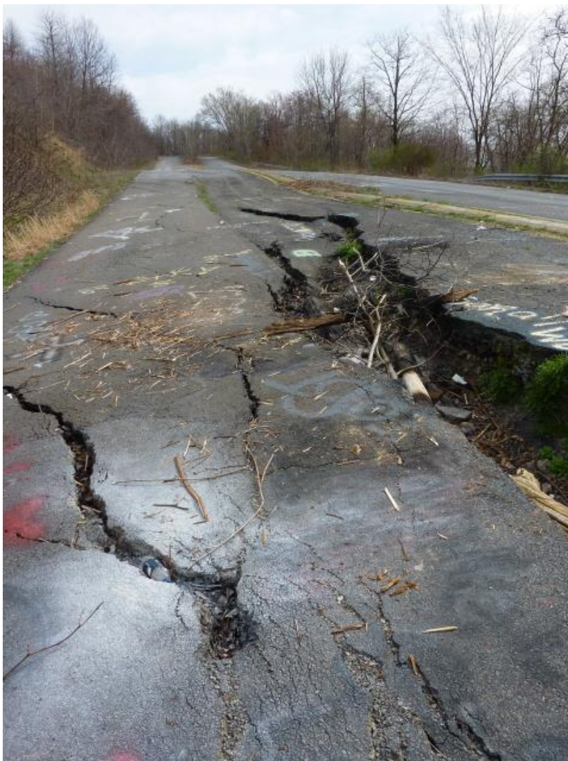
FIGURA 9 - RACHADURA NA RUA
