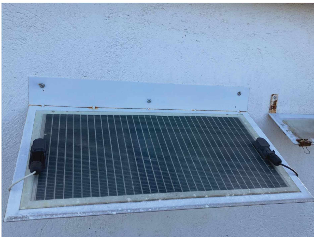
Figura 16 – Painel em que foram realizadas as medidas elétricas apresentadas no trabalho. O painel estudado possui uma área ativa de 1056 \text{ cm}^2 , com 32 células solares conectadas em série, formando um módulo.
