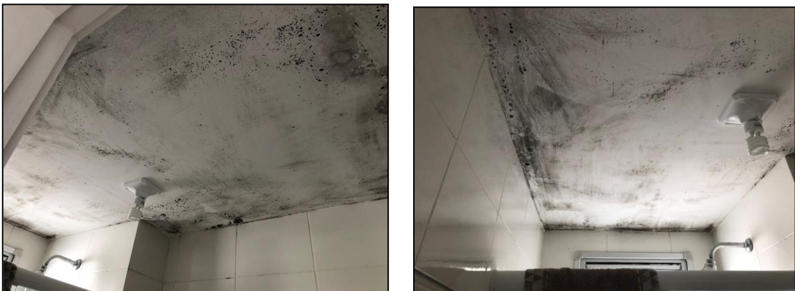
FIGURA 17 – TETO DO BANHEIRO DA SUÍTE
