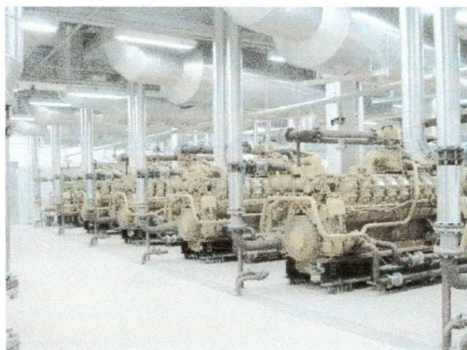
FIGURA 2 – OS MOTORES DA USINA DE GERAÇÃO DE ENERGIA DO ATERRO DO BANDEIRANTES-SP
