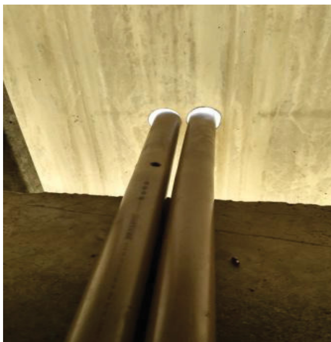
Figura 14 – Dois dos 4 drenos do sistema de climatização.
