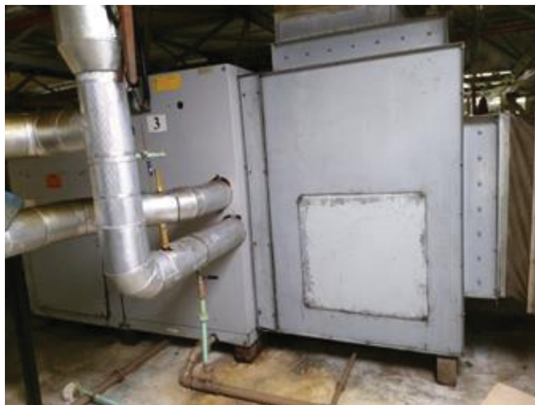
Figura 13 – Parte do sistema de climatização
