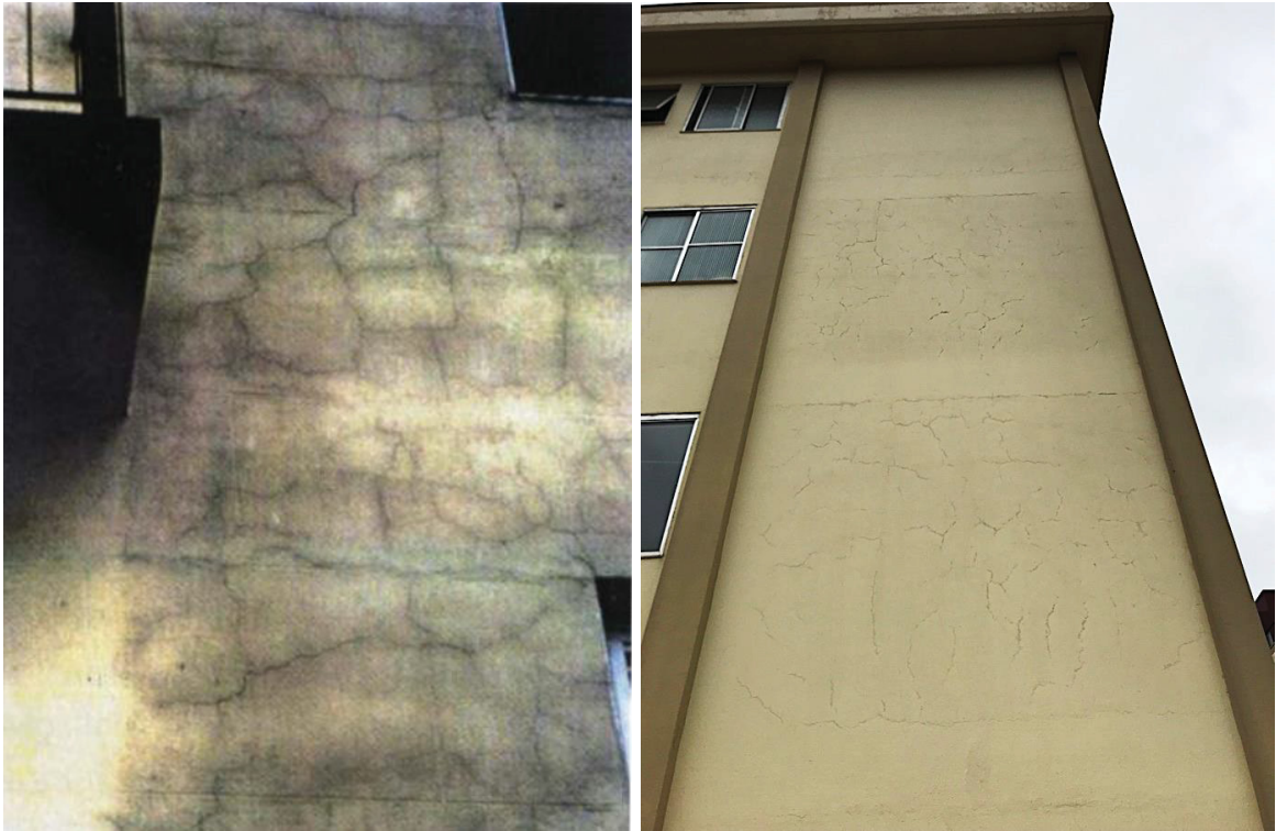
FIGURA 1 – FISSURAS MAPEADAS CAUSADAS POR REDUÇÃO DO VOLUME DA ARGAMASSA
