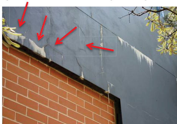
FIGURA 2 – MANCHAS DE EFLORESCÊNCIA ASSOCIADAS A FISSURAÇÃO MAPEADA EM FACHADA DE REVESTIMENTO DE ARGAMASSA
