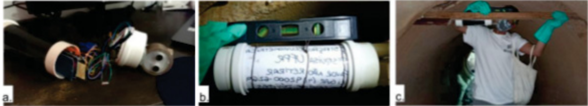
FIGURA 8 – INSTALAÇÃO DO SENSOR ULTRASSÔNICO
