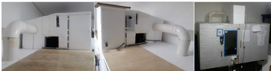
Figura 90 – Instalação do desumidificador concluída
