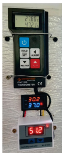
Figura 93 – Dispositivos do painel de controle da câmara climática
