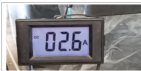
FIGURA 26 – Medição de corrente nas baterias
