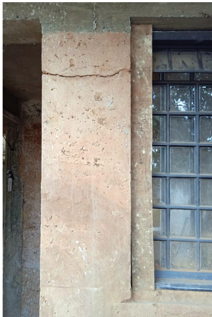
FIGURA 69 – OBSERVAÇÃO DO RESULTADO – PAREDE 1 – INTERFACE DA TAIPA COM A VIGA DE CONCRETO ARMADO
