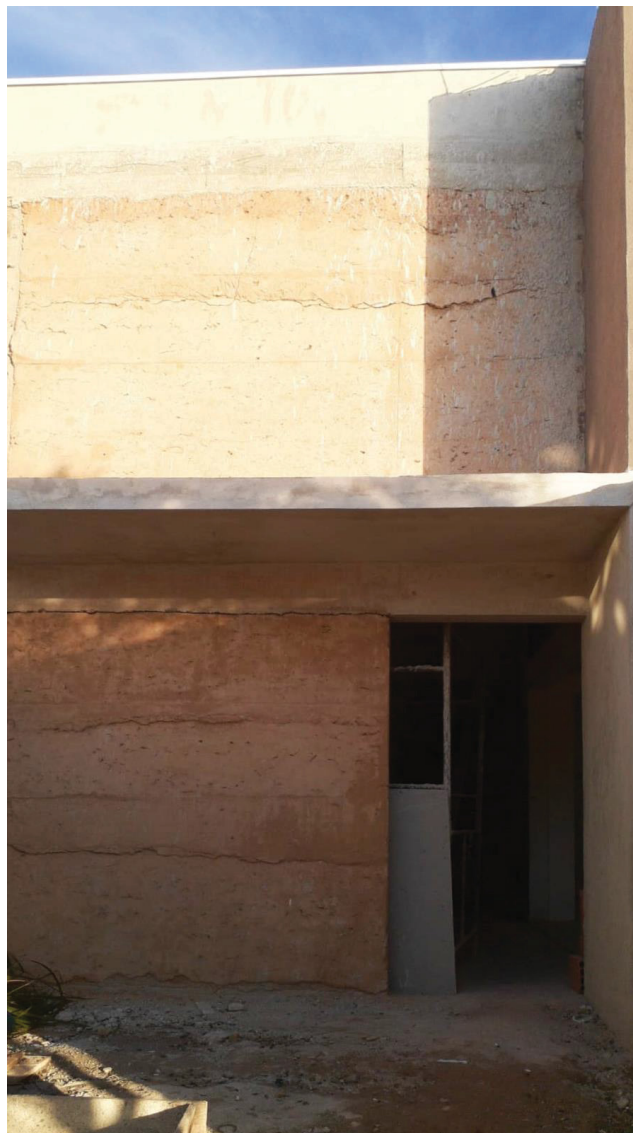
FIGURA 72 – OBSERVAÇÃO DO RESULTADO – PAREDE 3 – DESCOLAMENTO SUPERFICIAL
