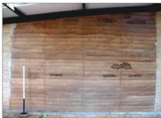
FIGURA 24 – TRECHOS COM ARRANCAMENTOS DE UMA PAREDE DE TAIPA
