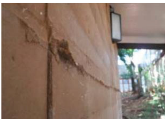
FIGURA 15 – DESAGREGAÇÃO ENTRE CAMADAS
