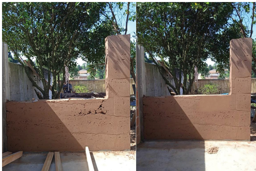
FIGURA 52 – DESFORMA DA PAREDE 1 – ANTES E DEPOIS DA APLICAÇÃO DA ARGAMASSA CORRETIVA
