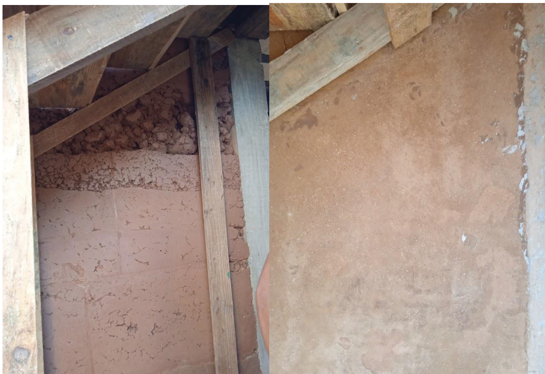
FIGURA 59 – DESFORMA DO PAINEL TÉRREO DA PAREDE 2 – ANTES E DEPOIS DA APLICAÇÃO DA ARGAMASSA CORRETIVA
