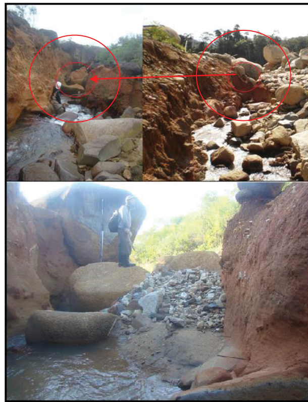
FIGURA 16 - MONITORAMENTO DE EROSÃO NA MARGEM DO RIO TINGIDOR. QUEDA DE BLOCO POR EROSÃO NA BASE DE SUSTENTAÇÃO, SEGUIDO DE ENTULHAMENTO POR OBSTRUÇÃO DO CANAL
