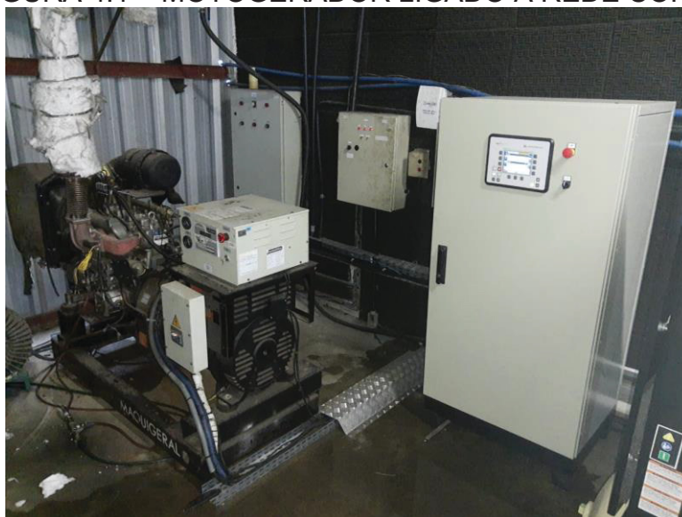
FIGURA 4.1 – MOTOGERADOR LIGADO A REDE COPEL
