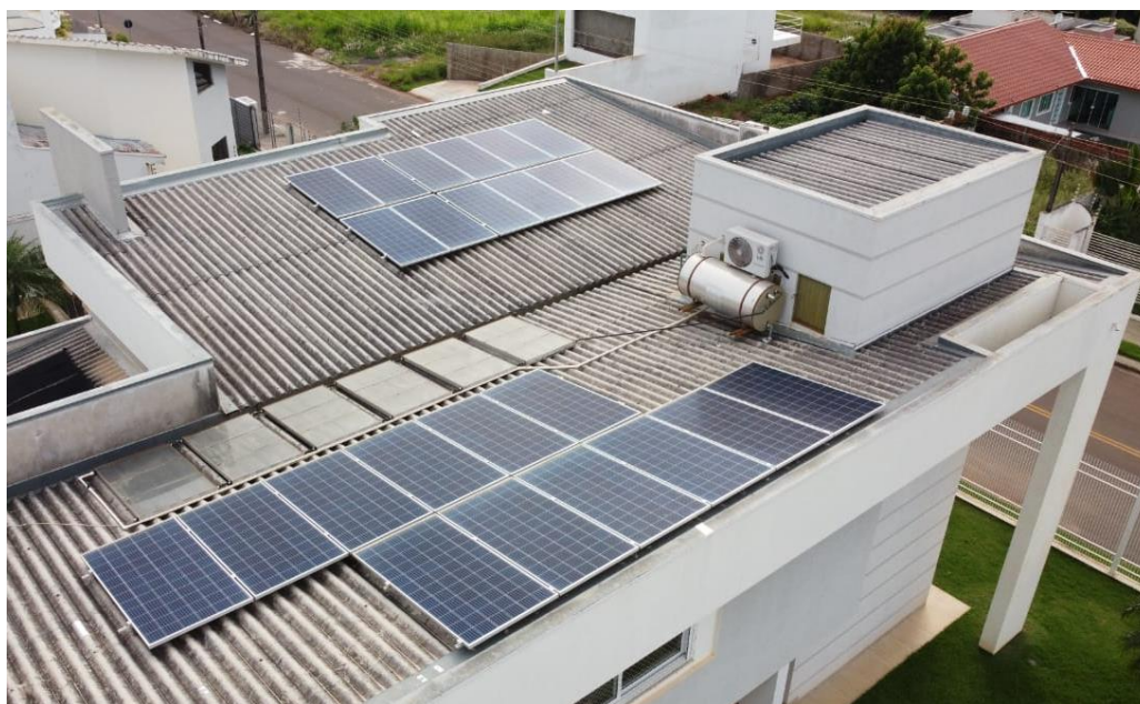
FIGURA 6- IMAGEM AÉREA DOS ARRANJOS FOTOVOLTAICOS
