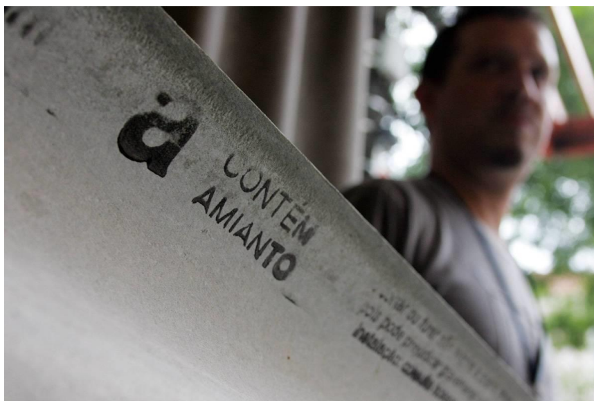
FIGURA 3 - AVISO PRESENTE EM TELHAS DE FIBROCIMENTO ALERTANDO PARA O RISCO DE INALAÇÃO DAS FIBRAS DE AMIANTO
