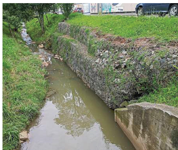
(b) Abaulamento e deformações no gabião
