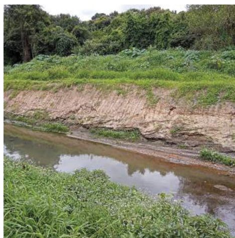
(b) Sulcos transversais a seção, oriundos de erosões pluviais e corrosão da base da margem devido à erosão fluvial
