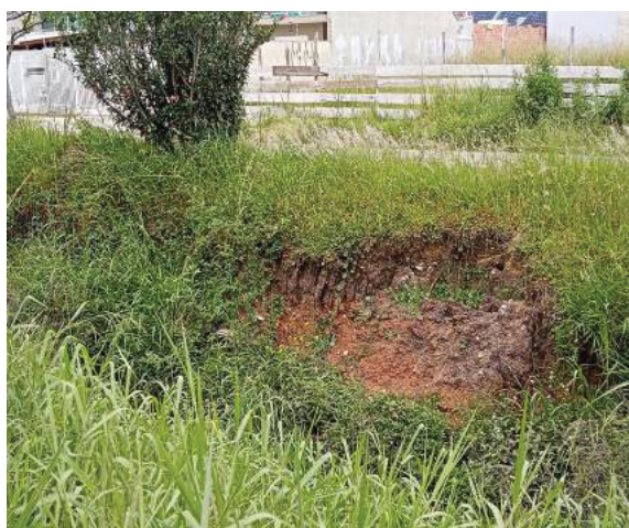
(a) Ruptura da margem
