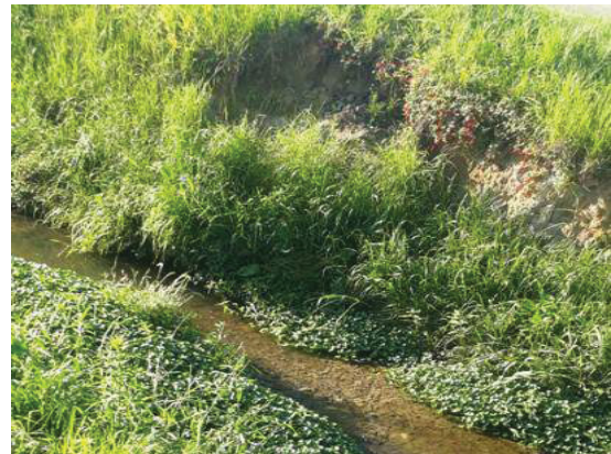
(c) Obstrução do leito vazante
