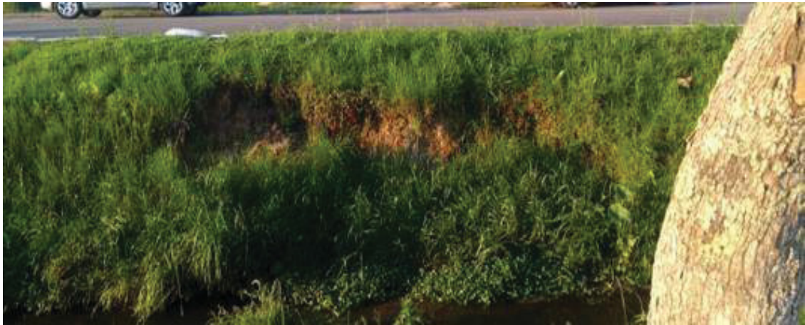
(a) Verticalização da margem no canal e queda de material
