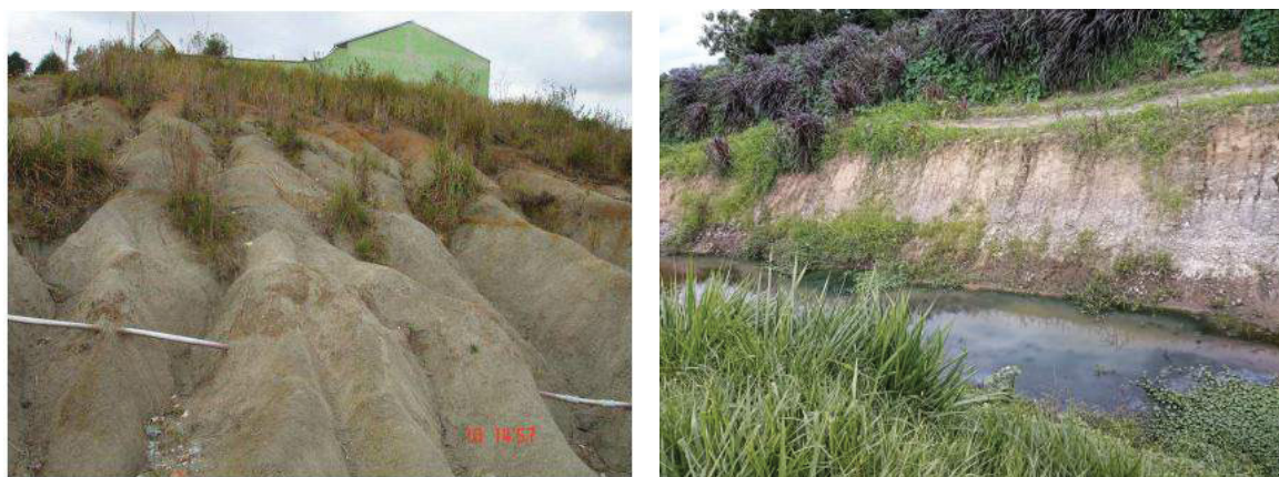
(a) Ravinamento profundo em saprólito de Gnaiss-Migmatito, com exposição de tubulação sulcos e verticalização do talude em solo aluvionar hidráulica e cobertura de solo remanescente, no topo do terreno
