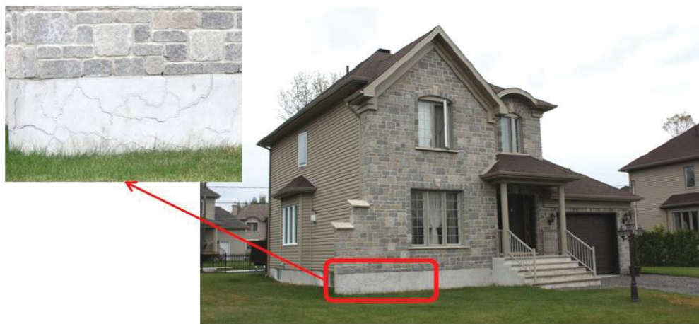
Figura 4 - Fissuras em na fundação de edificações residenciais em Trois-Rivières (Quebec - Canadá).
