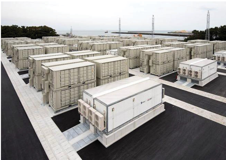
Figura 3: Sistema de armazenamento com baterias NaS, Japão.
