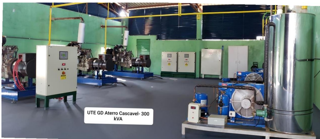
FIGURA 24 - SISTEMA DE GERAÇÃO DE ENERGIA ELÉTRICA DO ATERRO SANITÁRIO DE CASCVEL
