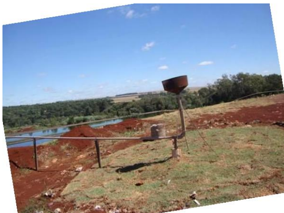
Sistema de tratamentos de gás
