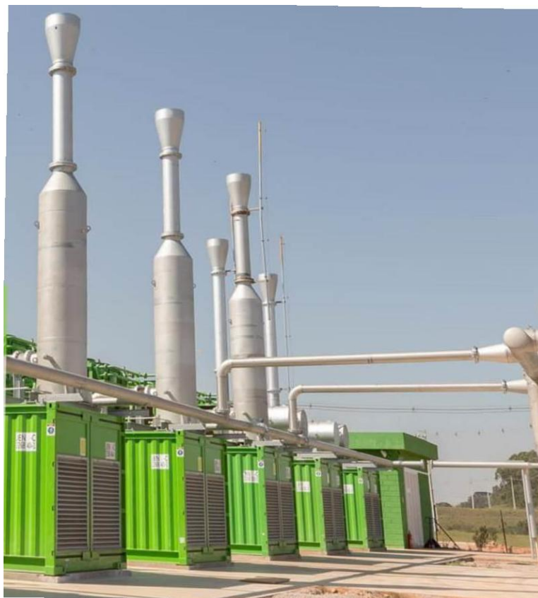
FIGURA 20 - SISTEMA DE GERAÇÃO DE ENERGIA ELÉTRICA DO ATERRO SANITÁRIO DE FAZENDA RIO GRANDE
