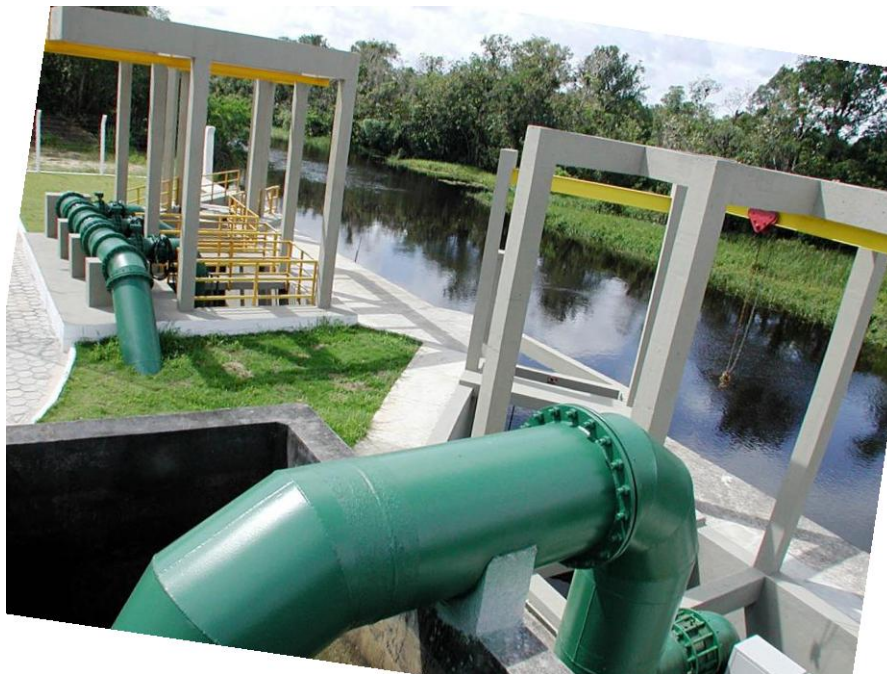
FIGURA 8: CAPTAÇÃO NO RIO DAS POMBAS
