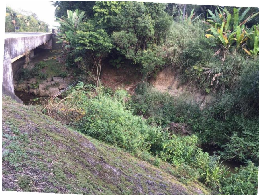
FIGURA 44: EROSÃO NO PONTO IFF03
