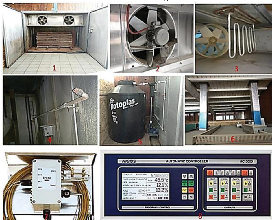
FIGURA 9 - CAMARA DE SECADO Y SISTEMAS DE CONTROL UTILIZADA PARA SECADO DE MADERA DE Tectona grandis .
