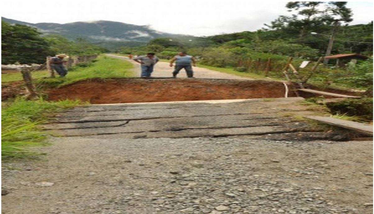
FIGURA 5 – QUEDA DA PONTE
