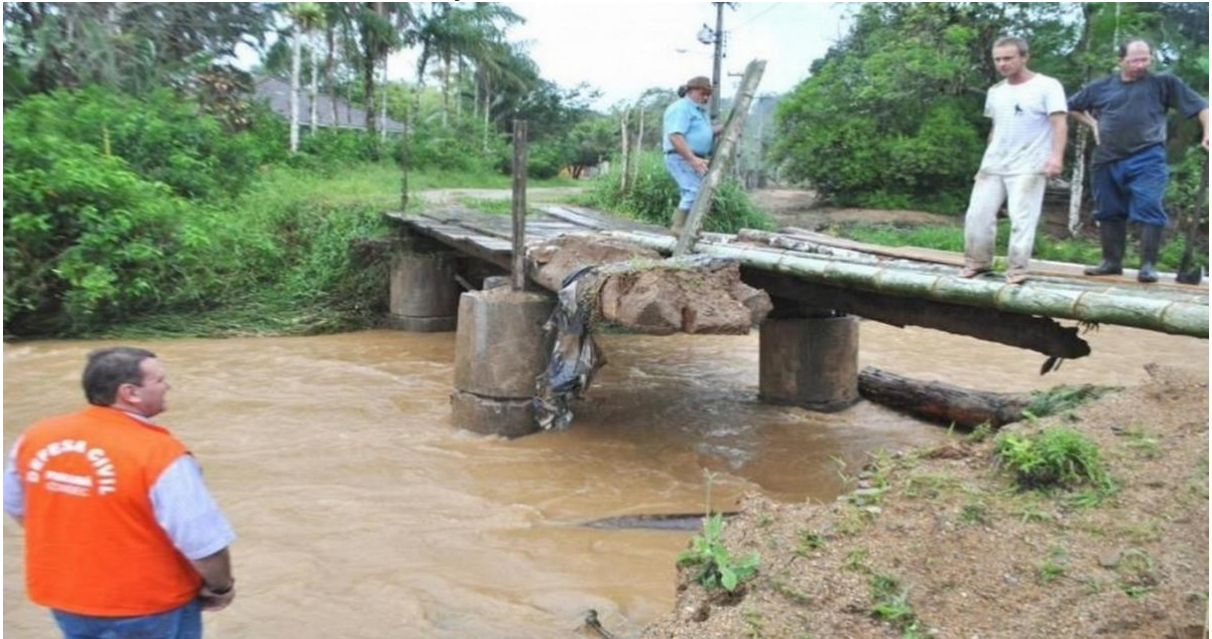
FIGURA 4 – SITUAÇÃO DA PONTE APÓS ENCHENTE DE 2011
