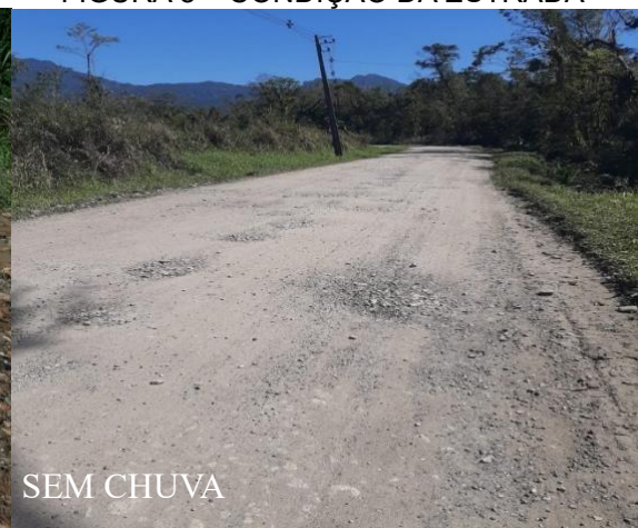
FIGURA 8 – CONDIÇÃO DA ESTRADA
