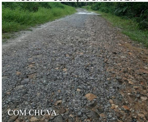
FIGURA 7 – CONDIÇÃO DA ESTRADA
