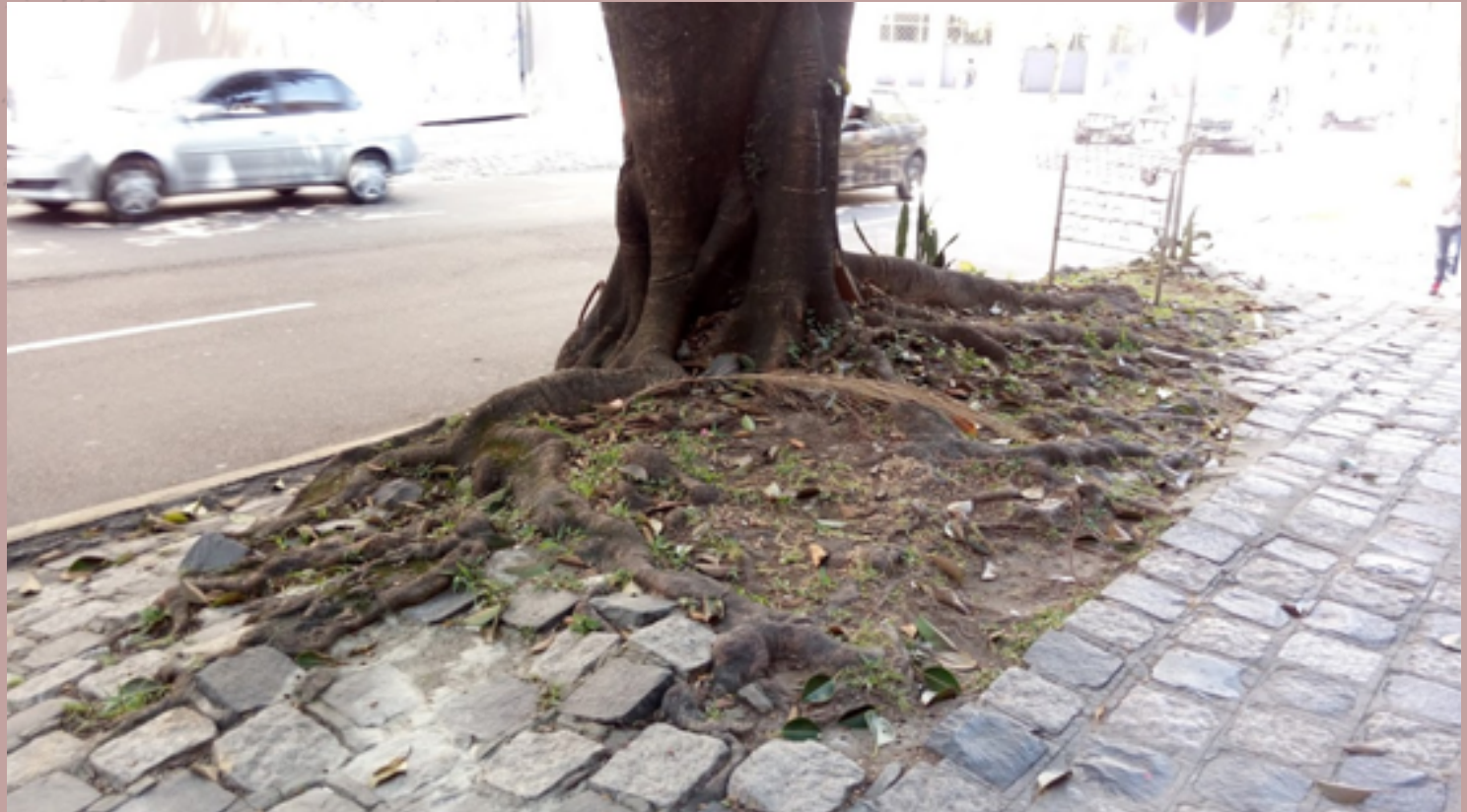
Figura 30: Desenvolvimento de raízes causando danos ao calçamento, em Curitiba (PR). Foto: Selma Barbosa Bastos
