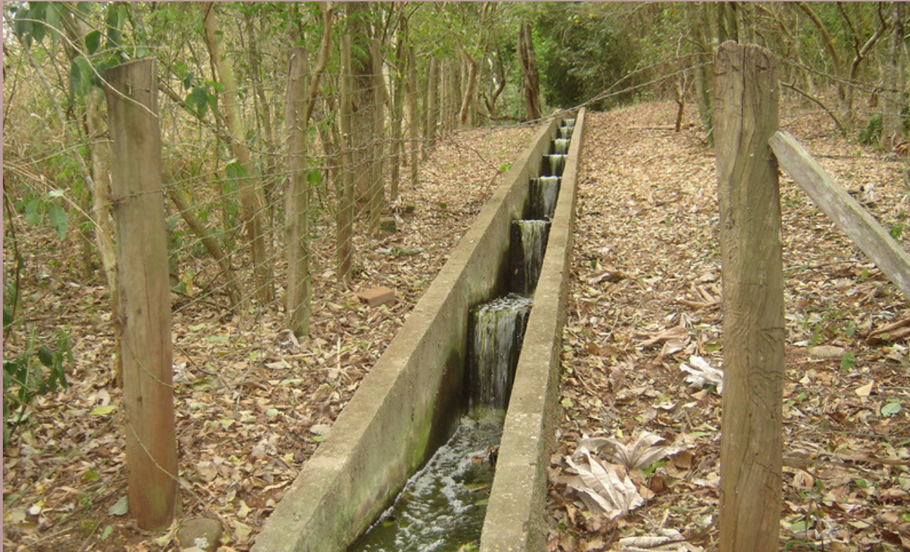
Figura 46: Saída de efluente de ETE em Jussara (PR). Foto: Marcelo Ricardo de Lima
