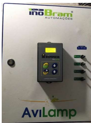
FIGURA 15 - PAINEL DE CONTROLE DO DIMMER
