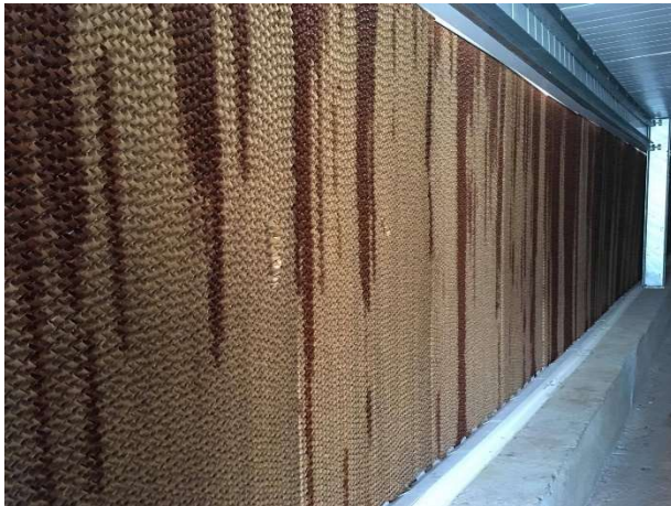
FIGURA 11 - PLACA EVAPORATIVA (PAD COOLING)
