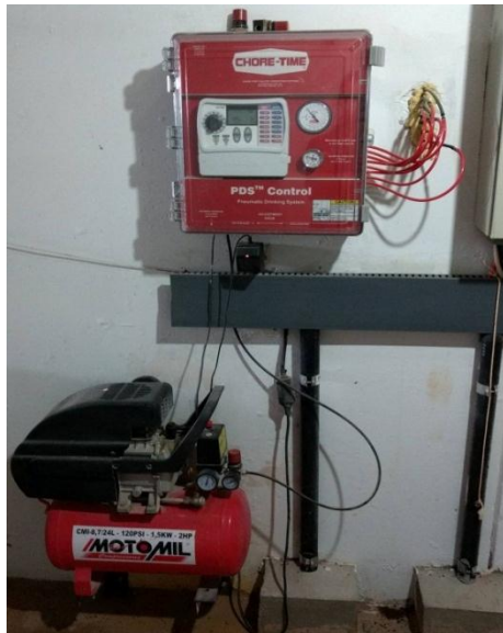
Figura 32 - Sistema de flushing automático.
