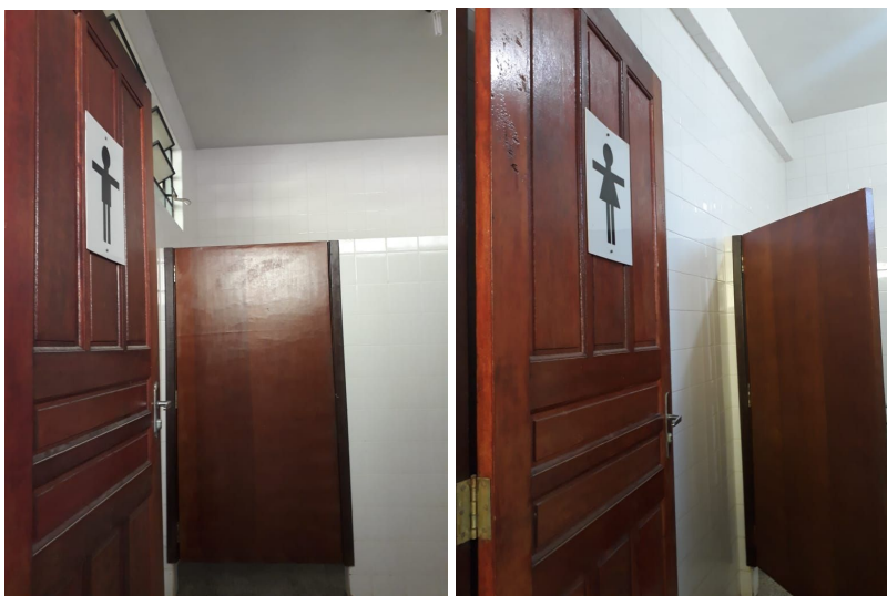
FIGURAS 17 e 18 - BANHEIROS ACESSÍVEIS MASC/FEM
