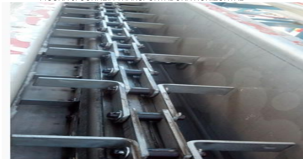
FIGURA 6: CORREIA TRANSPORTADORA HORIZONTAL
