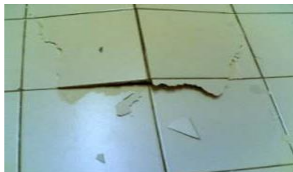
FIGURA 17 - RACHADURA EM PISOS
