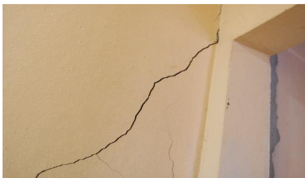
FIGURA 16 - TRINCAS EM PAREDE
