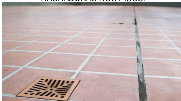
FIGURA 9 - JUNTAS DE DILATAÇÃO DE CONCRETO, PERMITINDO A EXPANSÃO E CONTRAÇÃO TÉRMICA, SEM QUE HAJA RACHADURAS NOS PISOS.
