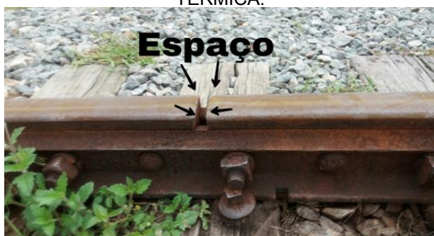
FIGURA 8 - JUNTA DE DILATAÇÃO EM FERROVIA, QUE AUXILIA NA REDUÇÃO DOS DANOS CAUSADOS PELA DILATAÇÃO TÉRMICA.
