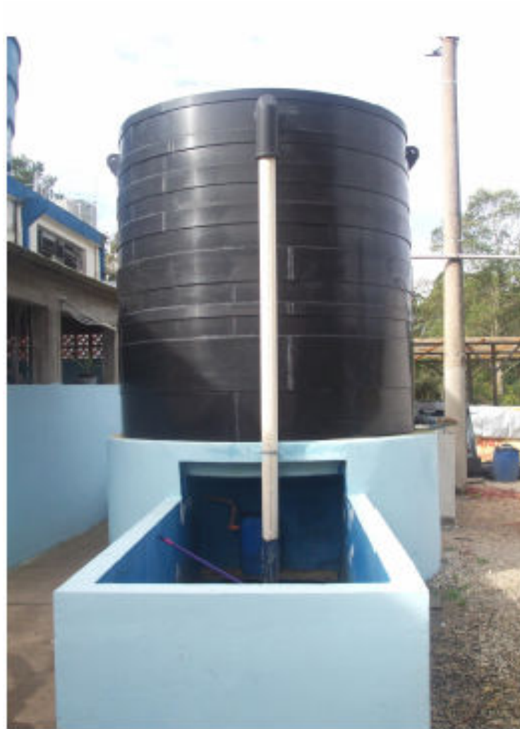
FIGURA 40 - DECANTADOR BIOLÓGICO E FÍSICO-QUÍMICO
