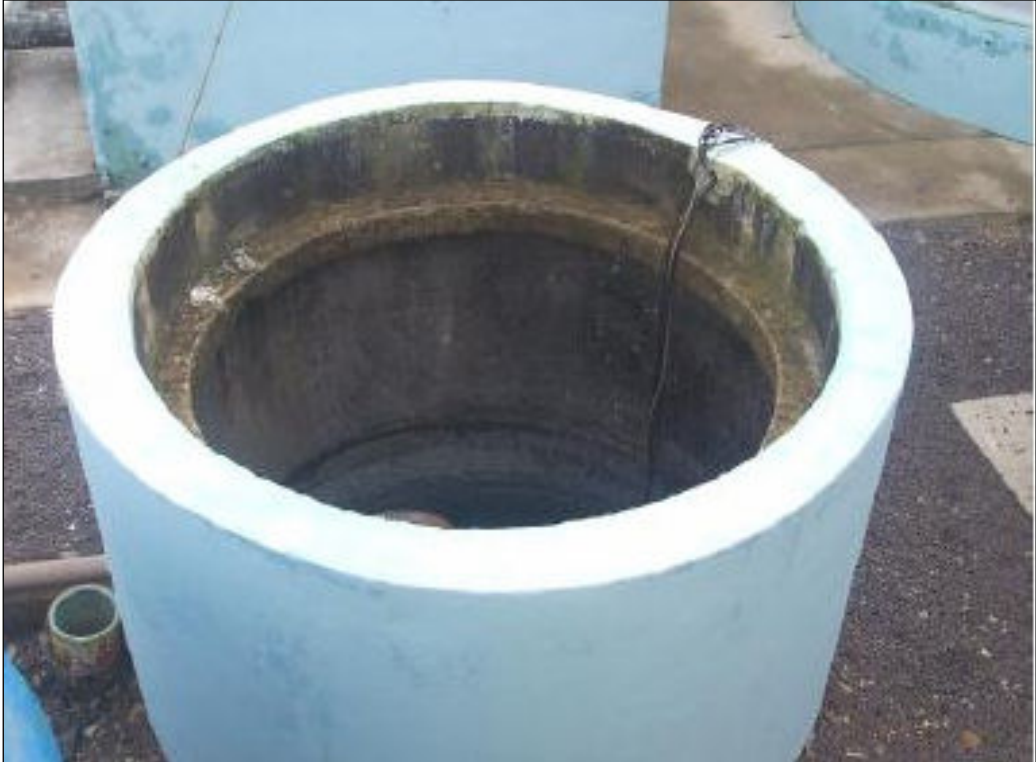
FIGURA 36. TANQUE DE MISTURA.
