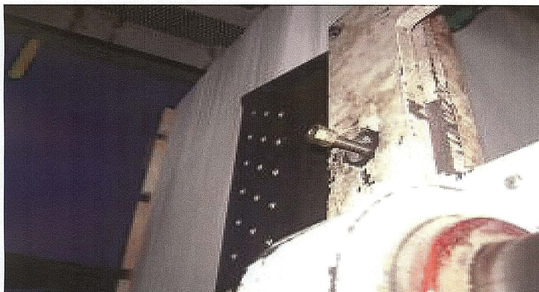
Figura 4. Peça com parafuso faltando para troca das chapas.
