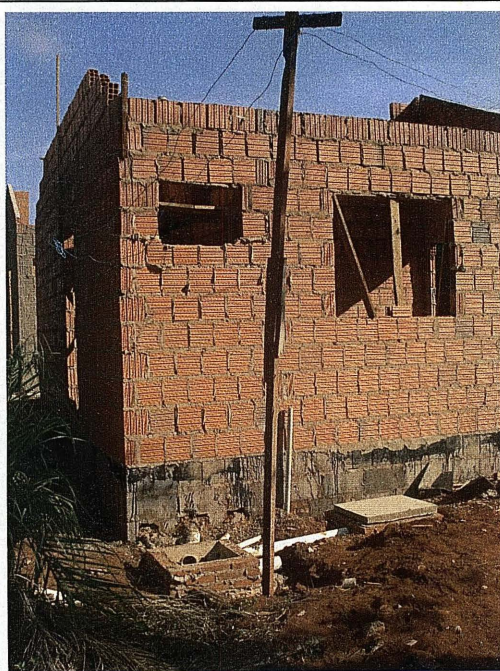
Figura 11- alvenaria desnivelada, desaprumada e falta de modulação.
