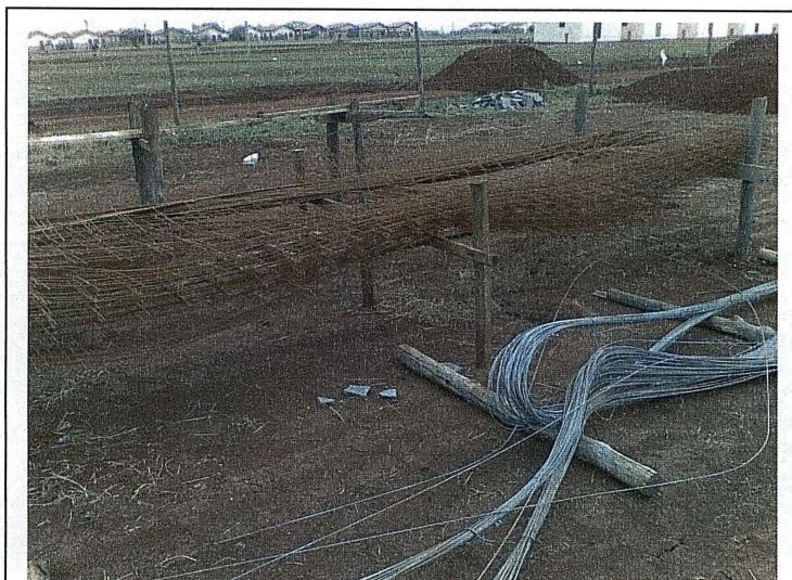
Figura 8- Aço em contato com o solo e dobrado, contrariando a norma de armazenamento do material
