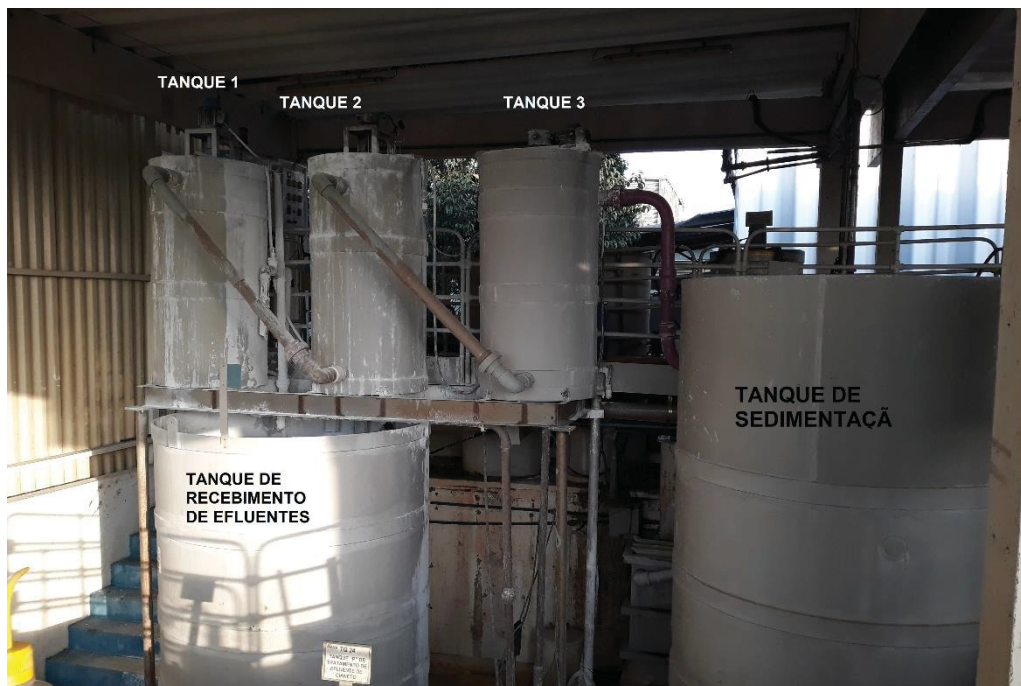
FIGURA 10 - ESTRUTURA DA ETE PARA TRATAMENTO DE ZAMAK
