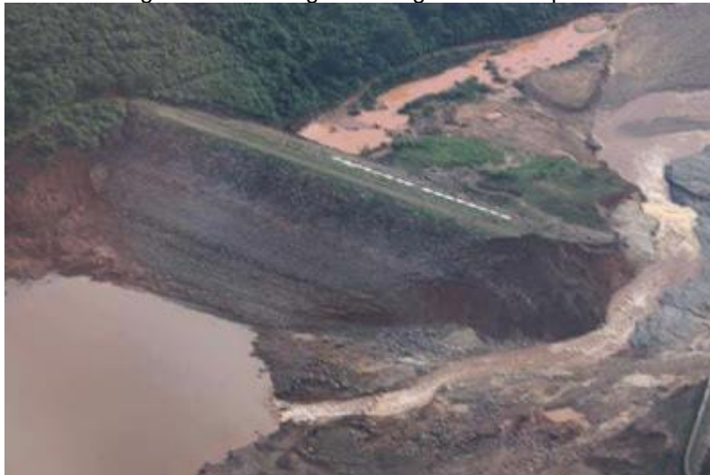
Figura 23 – Barragem de Algodões I rompida.
