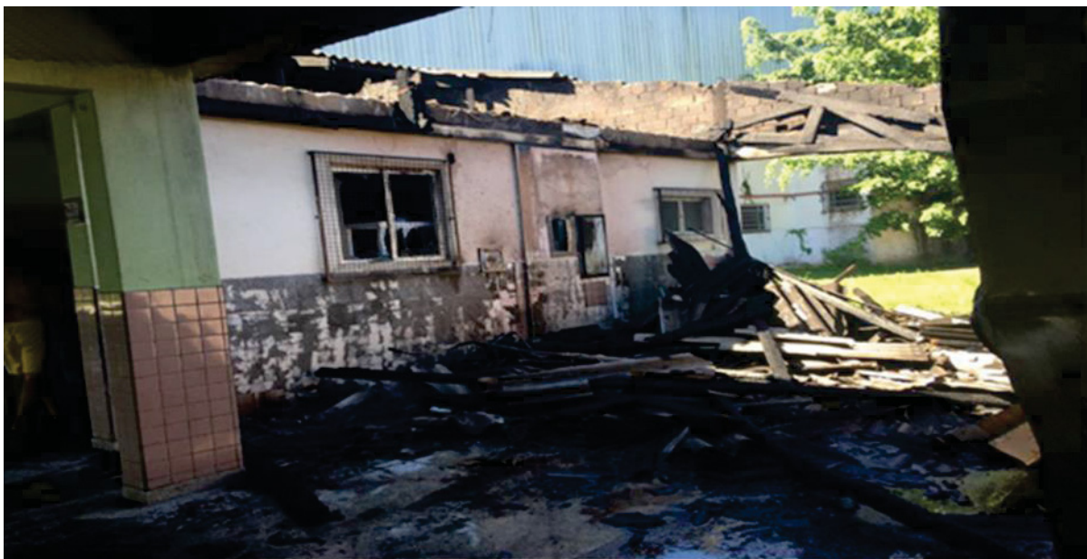
IMAGEM 2 - SITUAÇÃO DA ESCOLA APÓS INCÊNDIO
