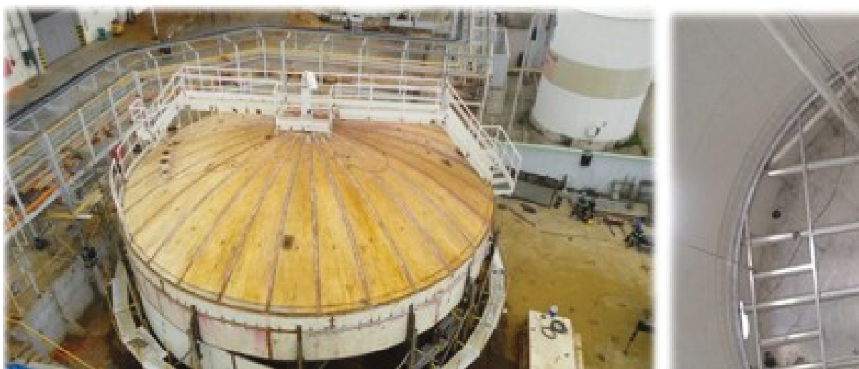
Figura 1 – Tanque sendo montado com processo invertido (imagem à esquerda) e montagem do selo (imagem à direita)
