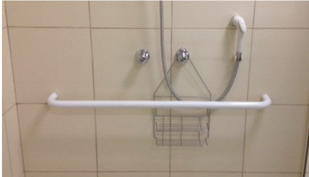
FIGURA 15 – BARRAS ACOPLADAS À PAREDE E DUCHA
