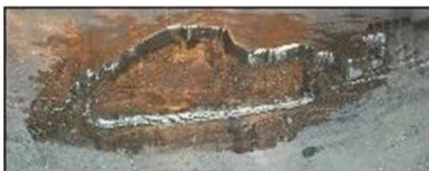
FIGURA 5: EXEMPLO DE CORROSÃO NAFTÊNICA ACELERADA POR VELOCIDADE EM COLUNA DE DESTILAÇÃO A VÁCUO. LINHA DE TRANSFERÊNCIA SOB EFEITO DE ALTA VELOCIDADE DE FLUXO, 380 °C, ASTM A335 P5.
