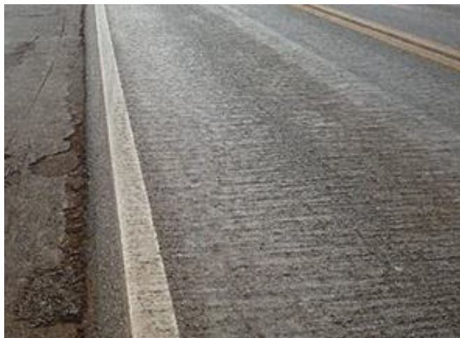
FIGURA 1 – CORRUGAÇÕES DEVIDO A TENSÕES CISALHANTES HORIZONTAIS DOS VEÍCULOS
