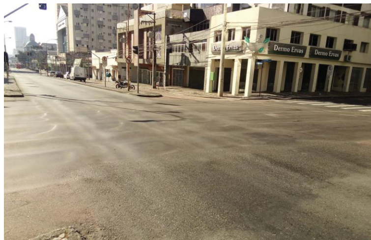
FIGURA 11 - AFUNDAMENTO COM SOLEVAMENTO LATERAL EM UM CRUZAMENTO DA RUA 24 DE MAIO COM O CORREDOR DE ÔNIBUS BRT DA AVENIDA SETE DE SETEMBRO EM CURITIBA.
