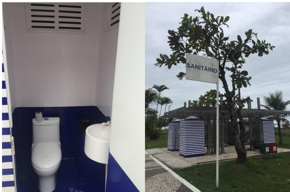
FIGURA 13 - BANHEIROS INSTALADOS NA ORLA DA PRAIA
