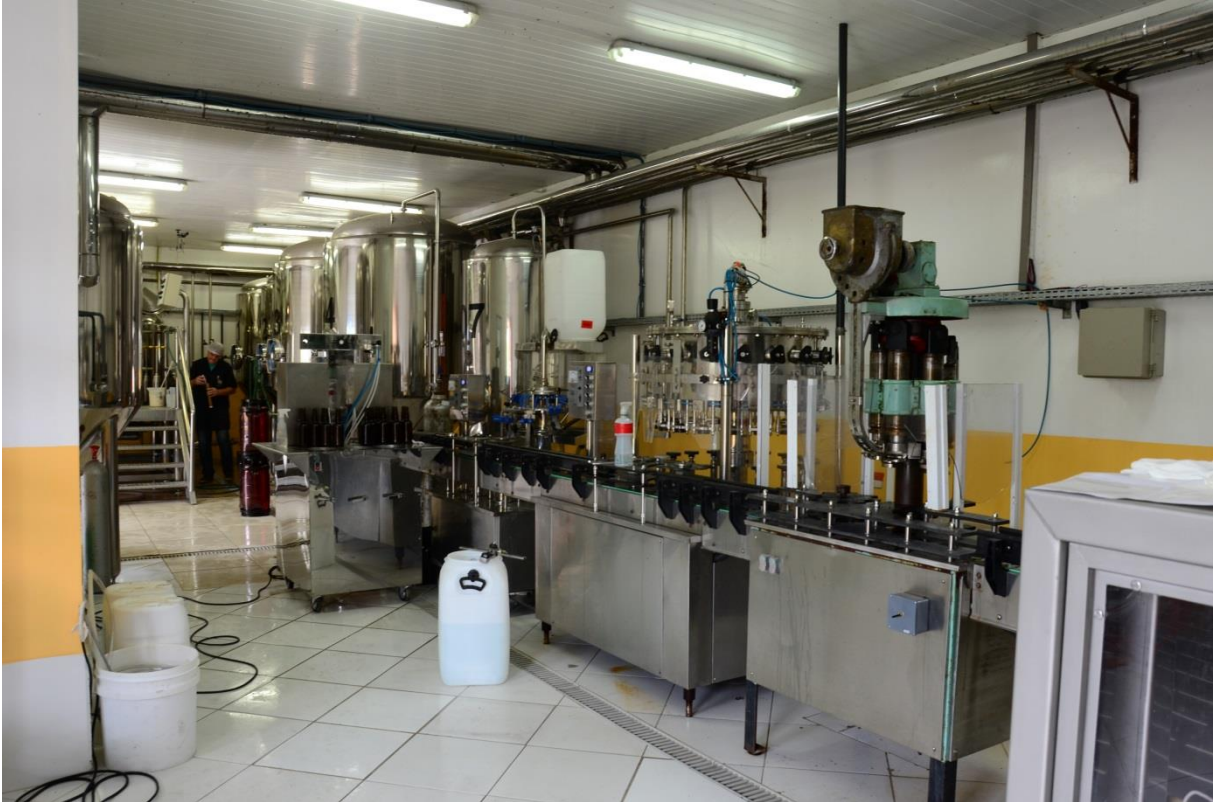
FIGURA 9: CASA DE MÁQUINAS FONTE: a autora (2015)
