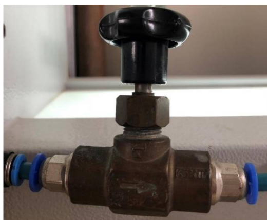
FIGURA 21 - Válvula agulha utilizada na saída da câmara de saturação.
