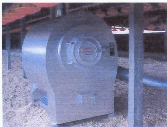
Sistema de Aquecimento
