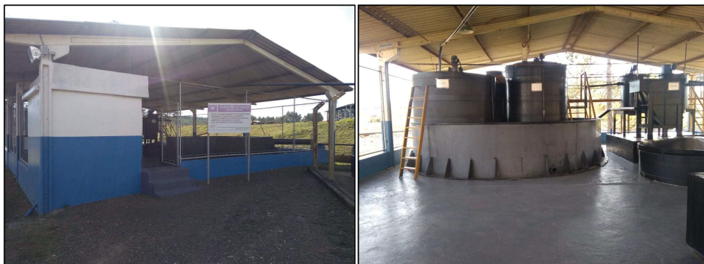
Foto 3 – Estação de Tratamento de Efluentes
