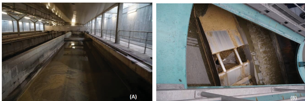
FIGURA 5 - DESARENADOR COM RASPADOR PARA REMOÇÃO DE GORDURA (A) E REMOÇÃO COMPLEMENTAR NO CLARIFICADOR PRIMÁRIO (B)
