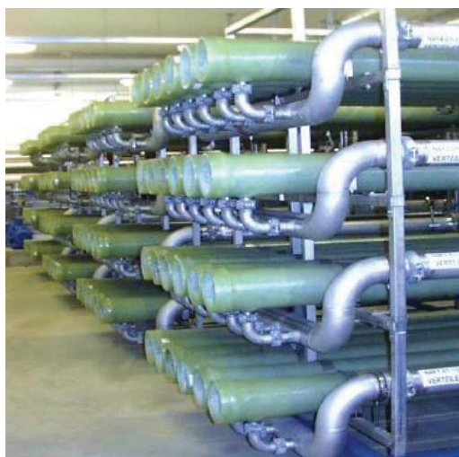
FIGURA 7- INSTALAÇÕES DO SISTEMA DE NANOFILTRAÇÃO
