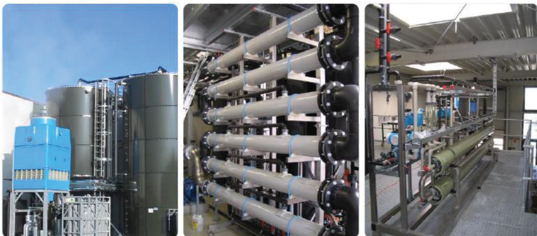
FIGURA 9 - INSTALAÇÕES DO SISTEMA DE TRATAMENTO DA LAVANDERIA INDUSTRIAL
