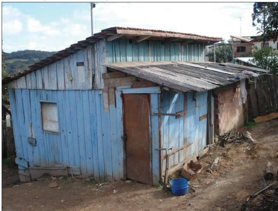
Figura 08 – Edificação a ser reformada por precariedade
