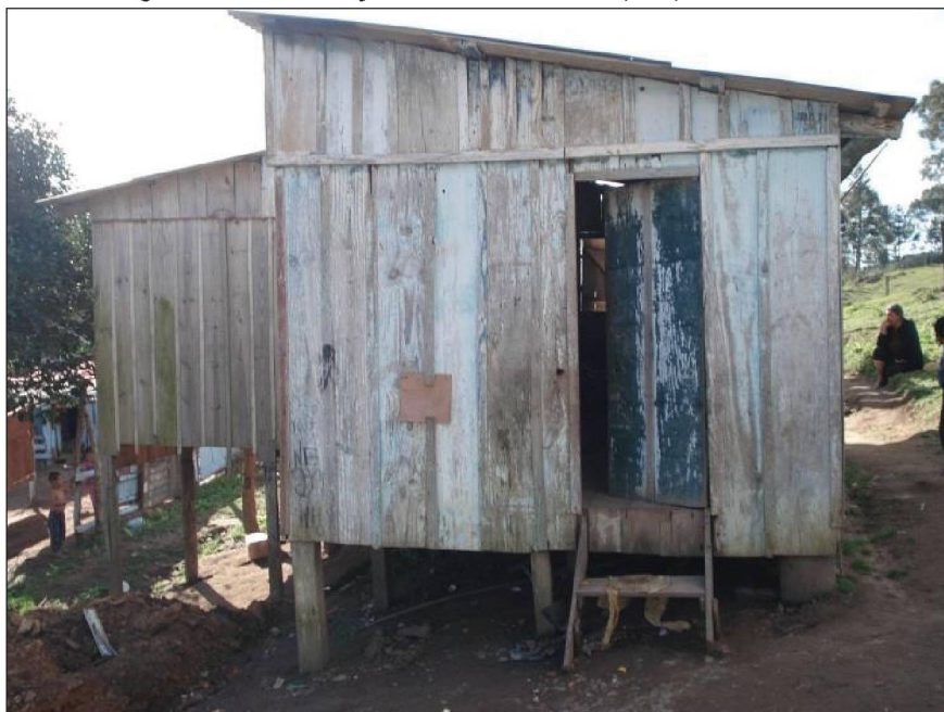
Figura 09 – Edificação a ser reformada por precariedade
