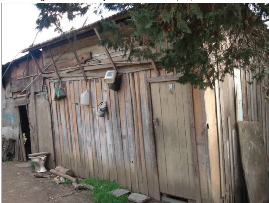
Figura 07 – Edificação a ser reformada por precariedade
